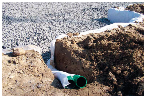
Figura 4.77 – Il vetro cellulare è stato steso. Si noti la fuoriuscita dallo scavo di fondazione delle estremità del tubo di drenaggio. Scavando, esso sarà condotto alla rete di raccolta delle acque
