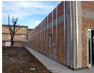
14 | Liceo Scientifico Majorana: Montaggio delle montanti verticali di sostegno della parete ventilata Majorana School: construction of ventilated façade frame
